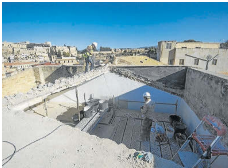
Dos operaris treballant en la millora del sostre de l'església, ahir al matí. FOTO: JOAN REVILLAS
